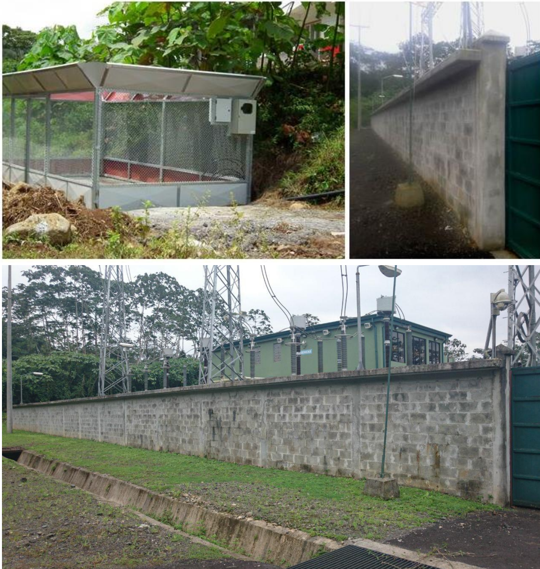
Figura 8. Imágenes ilustrativas de barreras perimetrales ideales para centro de interruptores y subestaciones (imágenes fuente CNFL).
